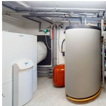
Moderne Indoor Wärmepumpenanlage
